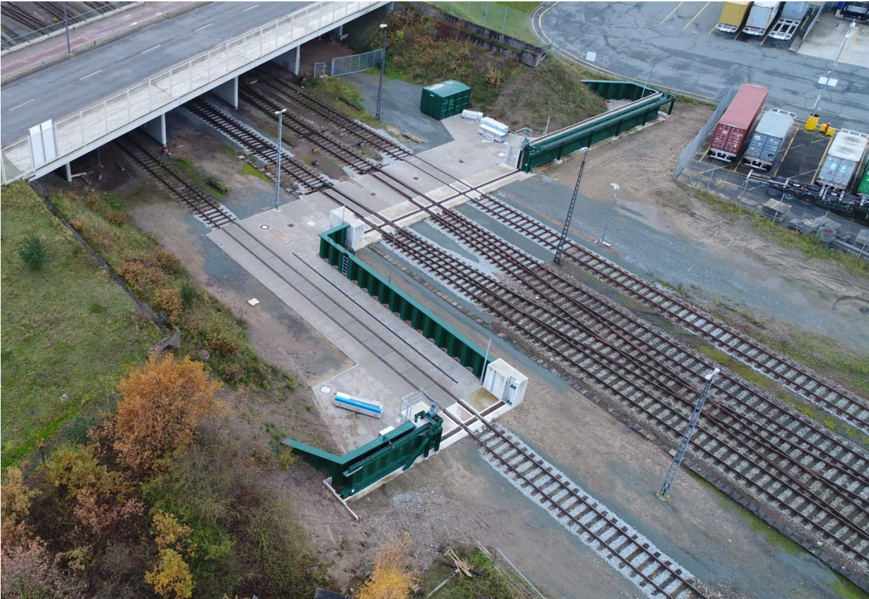
Hochwasserschutzstore Eisenbahnzufahrt Neustädter Hafen
